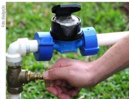
Foto: divulgação A Sanepar alerta que a instalação indevida de bloqueadores infringe a legislação e pode causar riscos à saúde pública
