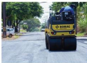
Moradores querem que a prefeitura faça recapeamento asfáltico em todas as ruas com pedras poliédricas
