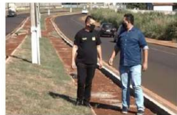
Vereadores João Morales e Cabo Cassol visitaram as obras de ciclovia da Av. Andradina
