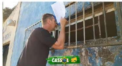
Imóvel alugado pela Saúde para bens inservíveis armazena máquinas novas em plástico bolha. Cassol observa o local
